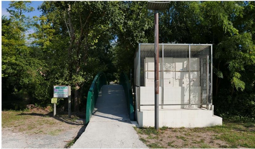
Mât d'éclairage / transformateur
